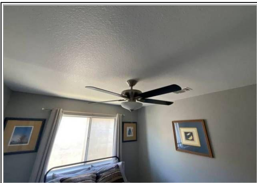
BEDROOM 4 CEILING FAN
