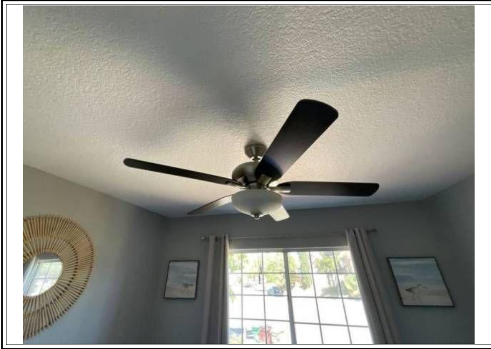
BEDROOM 2 CEILING FAN
