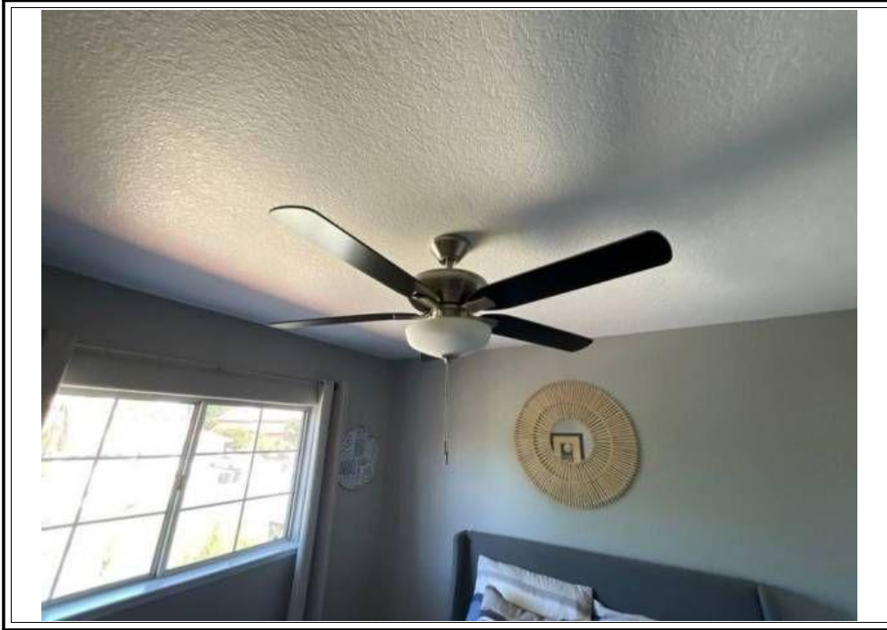
BEDROOM 3 CEILING FAN
