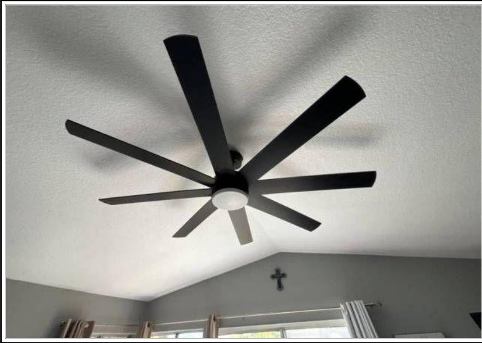
BEDROOM 5 CEILING FAN
